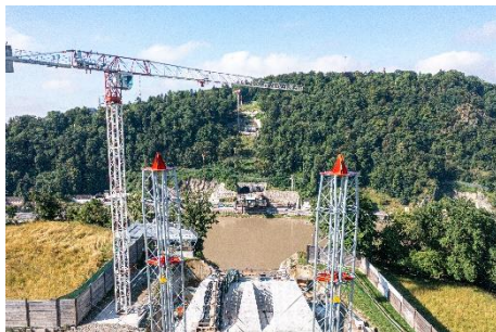
Sicht von Abspannpunkt Süd in Richtung Abspannpunkt Nord
