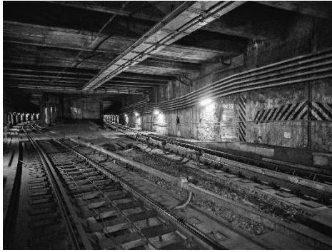
Absprungbauwerk U5 zweigleisiger Teil, Blickrichtung Station Schottentor/Frankhplatz, 360 Grad Scan inklusive Aufnahme Oberbau
